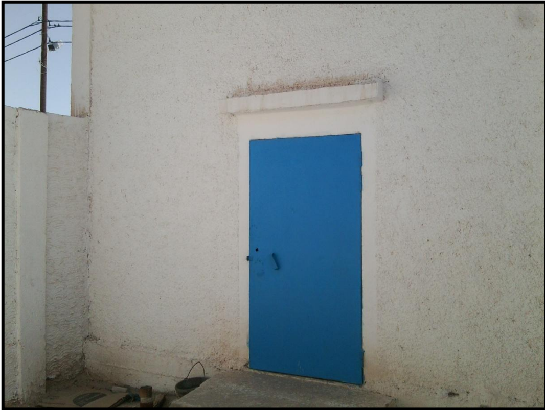
Photos N° II-21 : Chambre de transformateur de la station relevage SR04.
