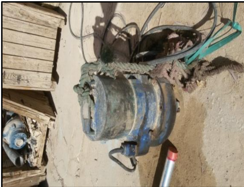
Photos N° II-25 : Pompe submersible en panne de la station de relevage SR06.
