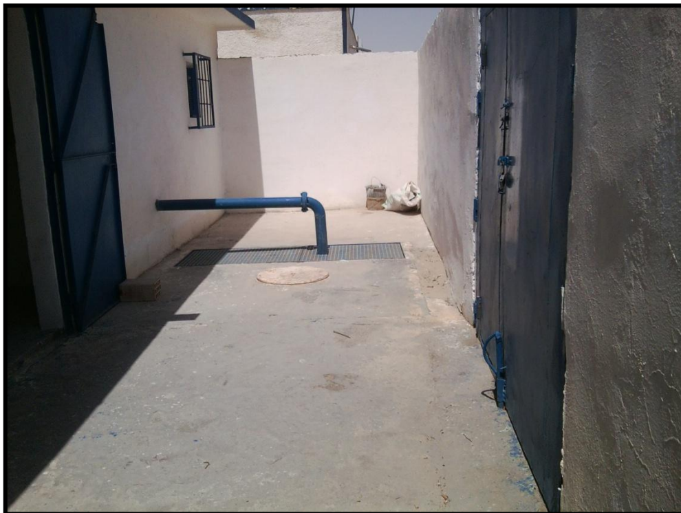
Photos N° II-07 : Chambre des vannes de la station relevage SR03.
