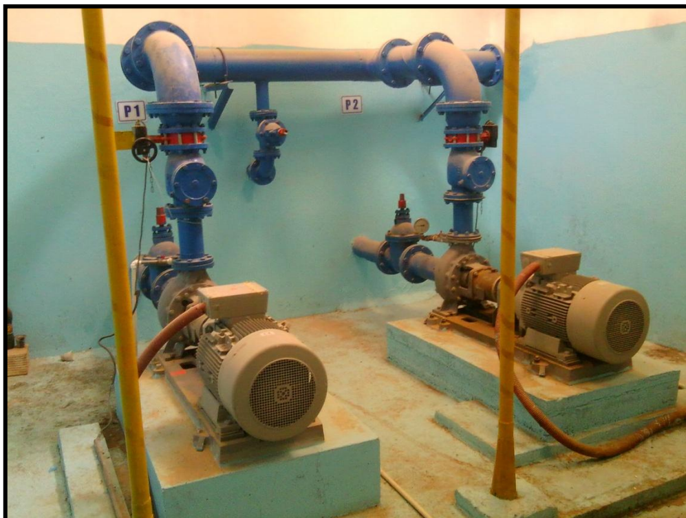
Photos N° II-06 : Les pompes horizontales de la station relevage SR03.
