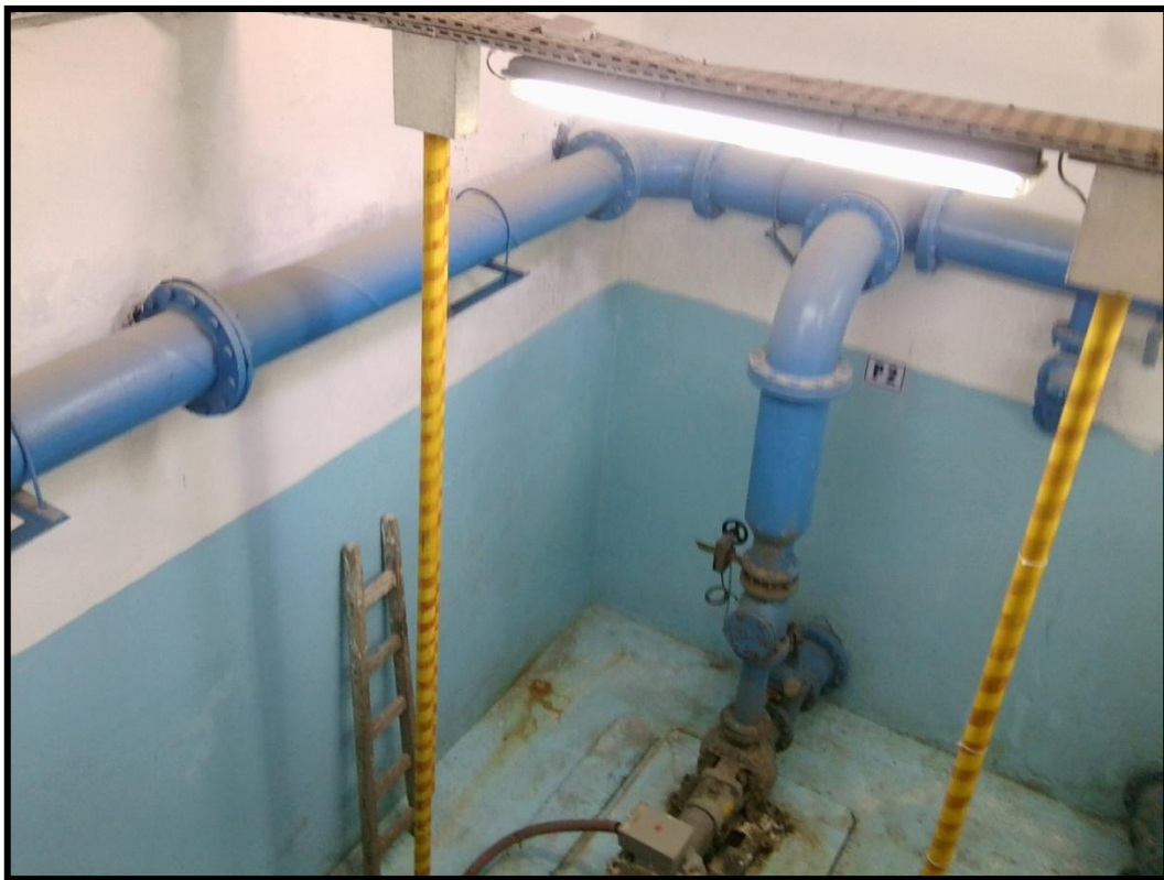
Photos N° II-18 : Chambre des vannes de la station relevage SR04.
