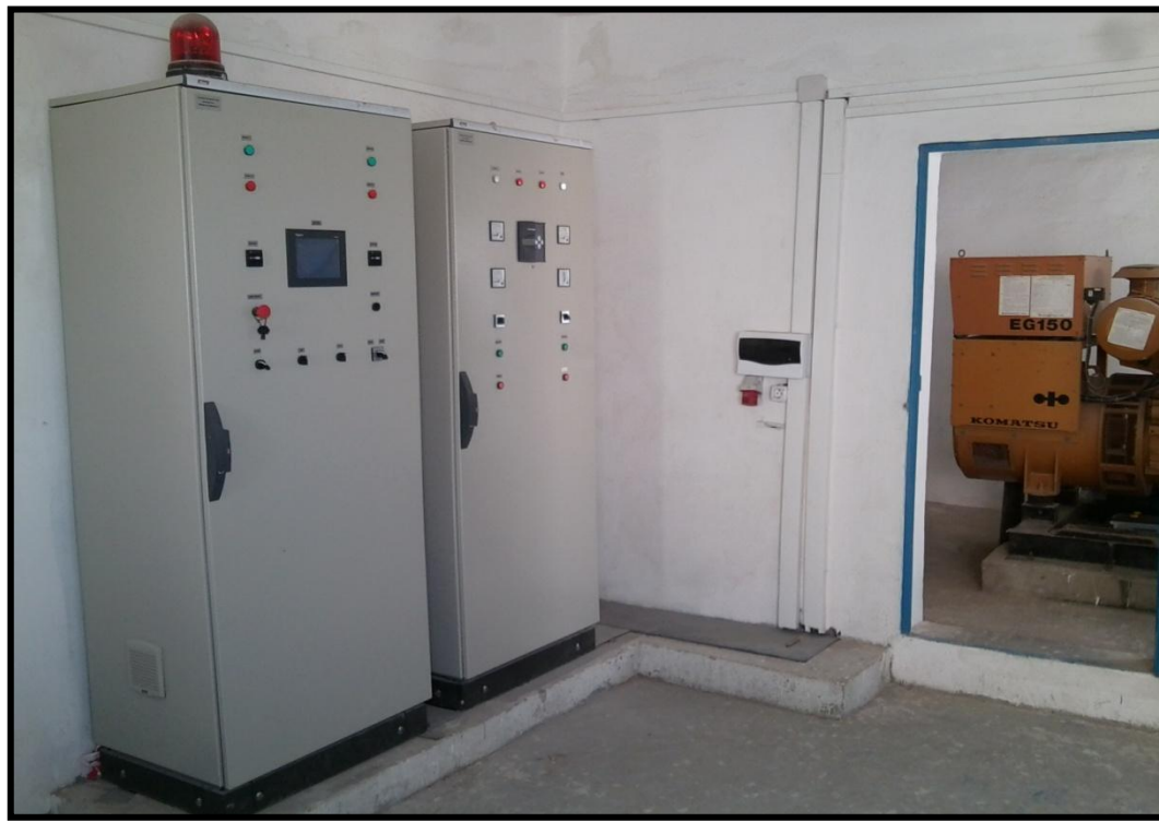
Photos N° II-14 : Armoires électriques de la station relevage SR04.
