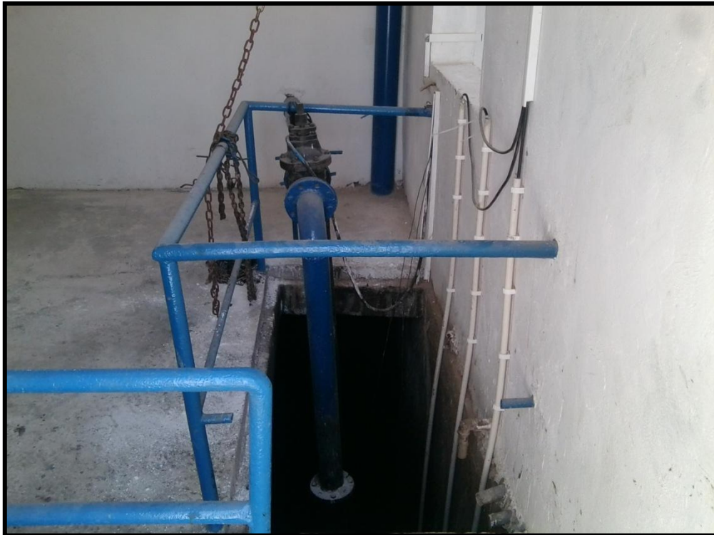
Photos N° II-04 : La bête de stockage de la station relevage SR03.
