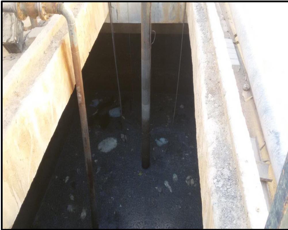
Photos N° II-26 : La bâche de stockage de la station de relevage SR06.
