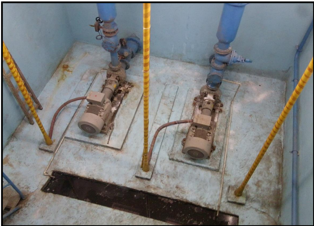
Photos N° II-17 : Les pompes horizontales de la station relevage SR04.
