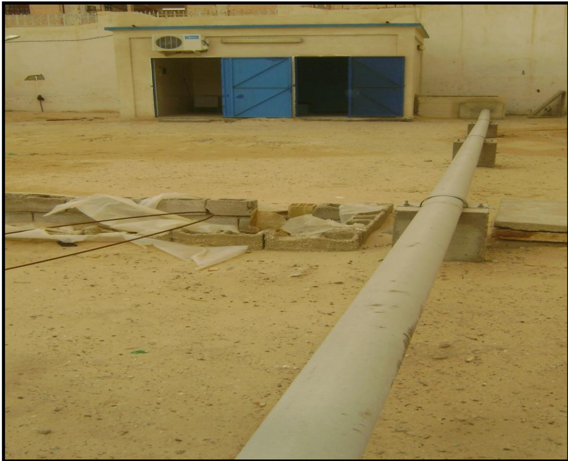
Photos N° II-34 : Conduite de refoulement de la station de relevage SR 400 Logts.
