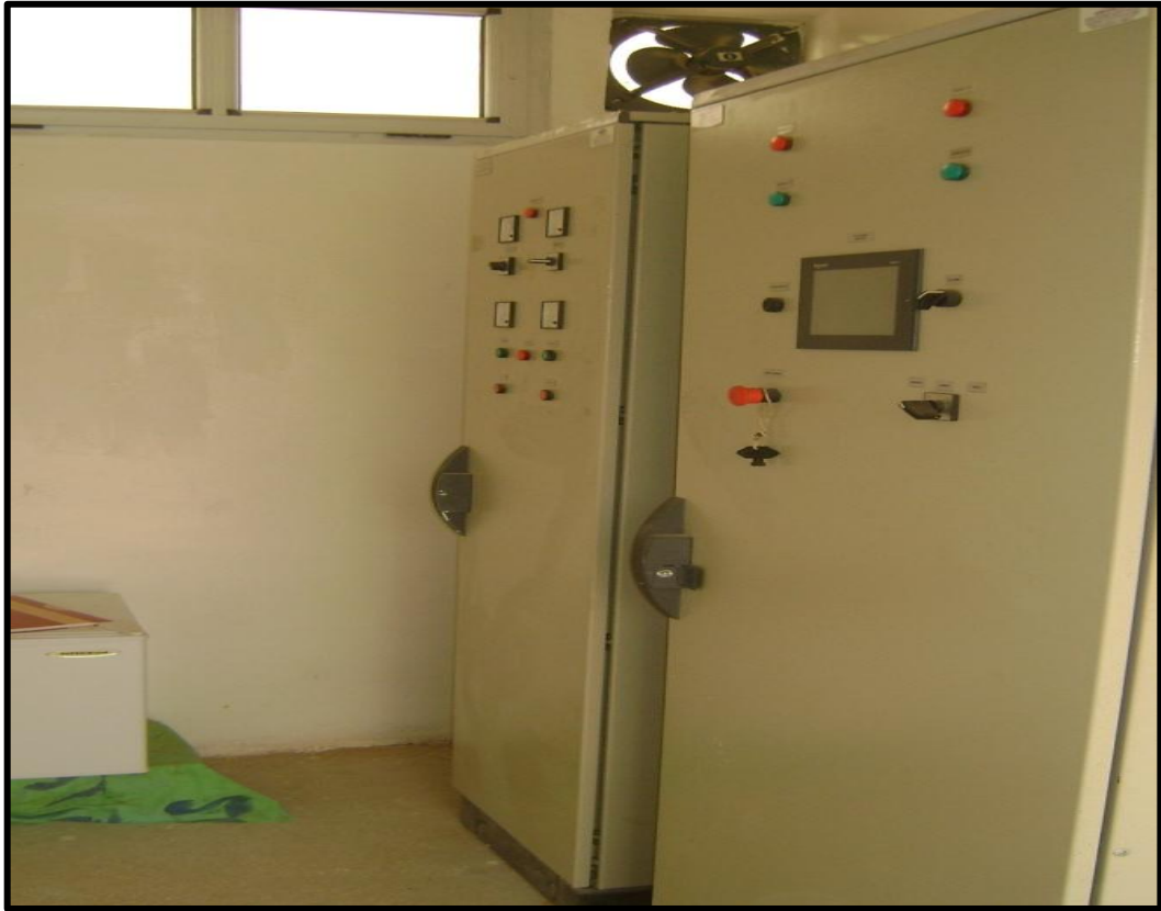
Photos N° II-31: Les Armoires électriques de la station de relevage SR 400 Logts.
