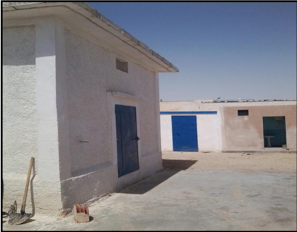
Photos N° II-10 : Chambre de transformateur de la station relevage SR03.
