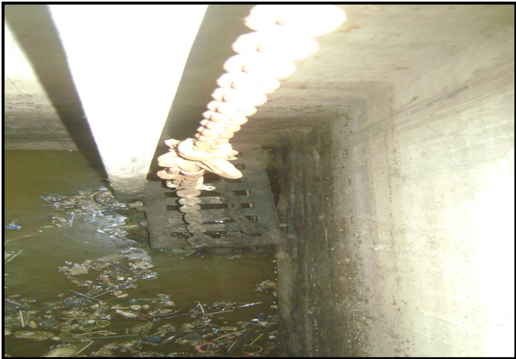
Photos N° II-32 : La bâche de stockage de la station de relevage SR 400 Logts.
