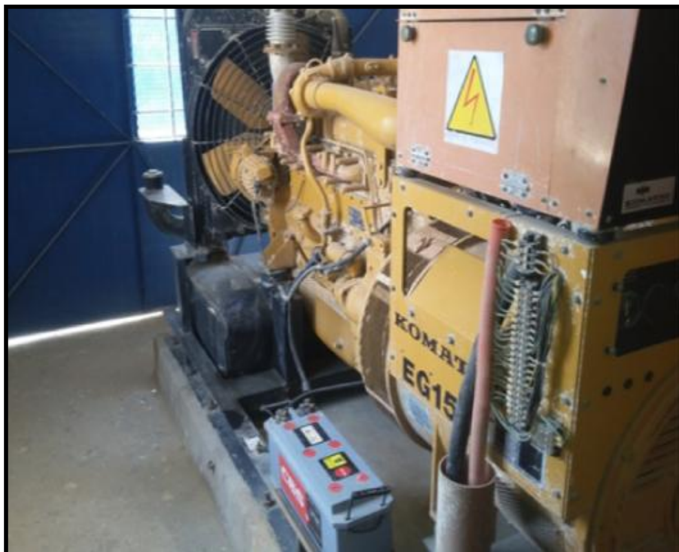
Photos N° II-08 : Chambre du groupe électrogène de la station relevage SR03.
