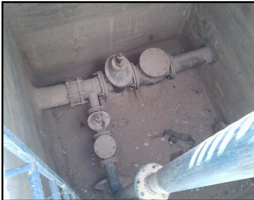
Photos N° II-11 : Chambre des vannes de la station relevage SR03.
