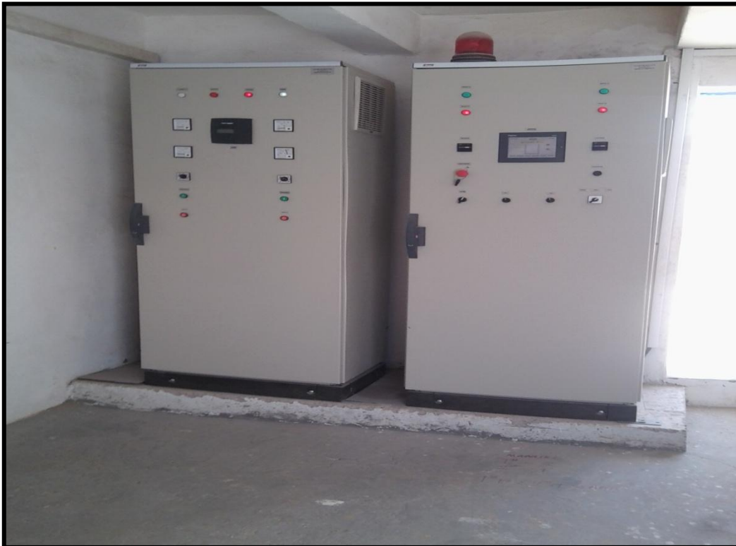
Photos N° II-03 : Armoires électriques de la station relevage SR03.
