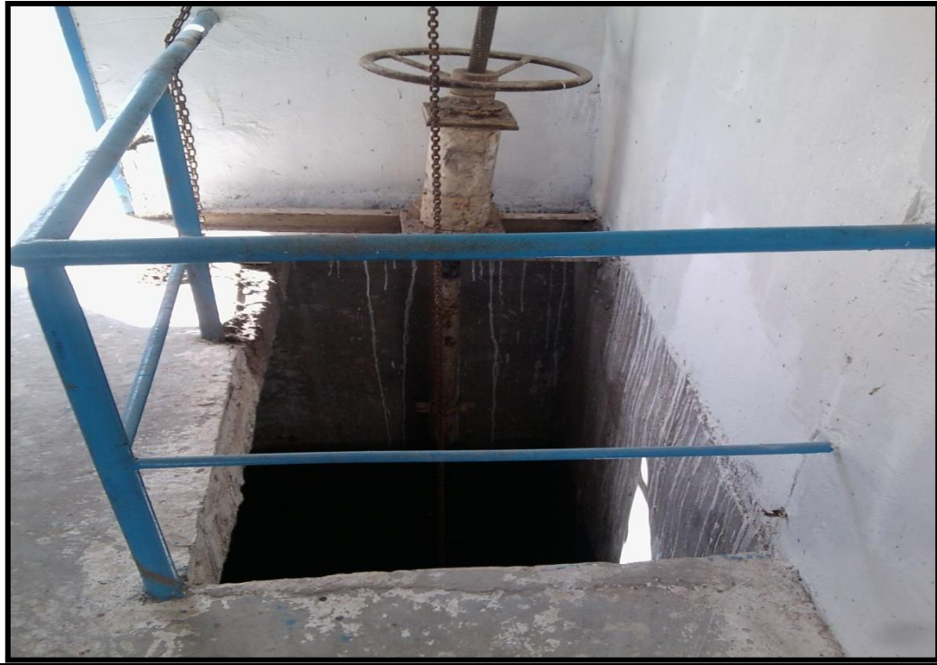
Photos N° II-15 : La bête de stockage de la station relevage SR04.
