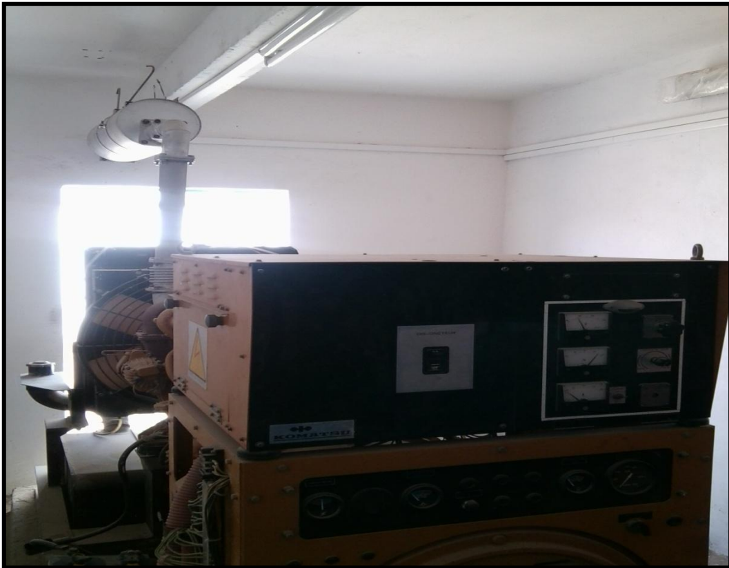
Photos N° II-19 : Chambre du groupe électrogène de la station relevage SR04.
