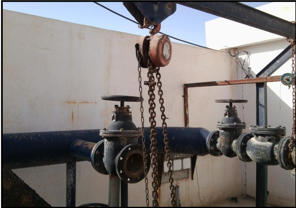
Photos N° II-27 : Les équipements de la station de relevage SR06.
