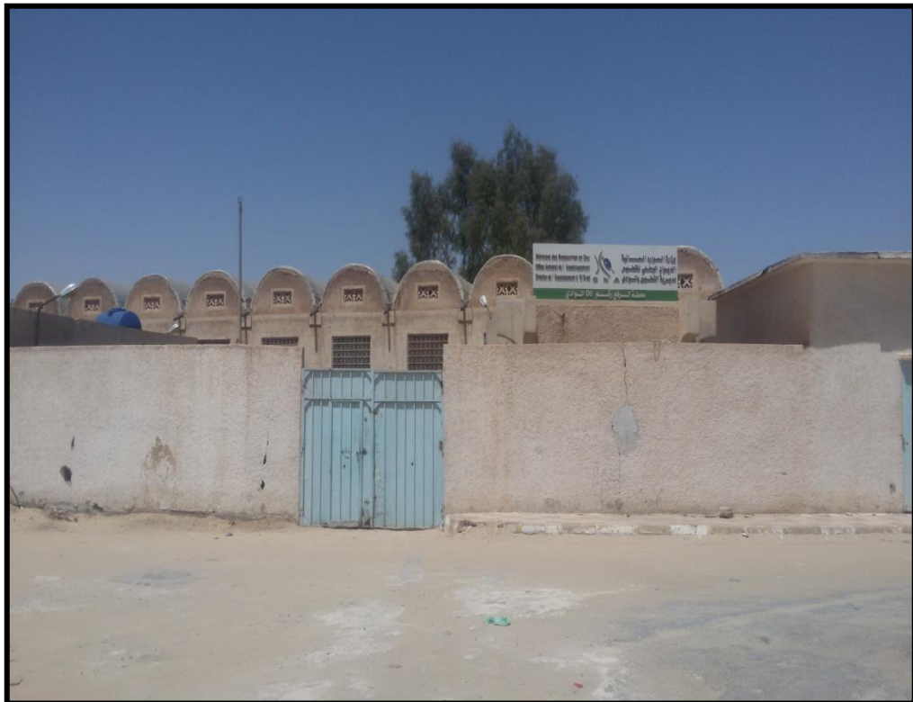
Photos N° II-22 : station de relevage SR06.
