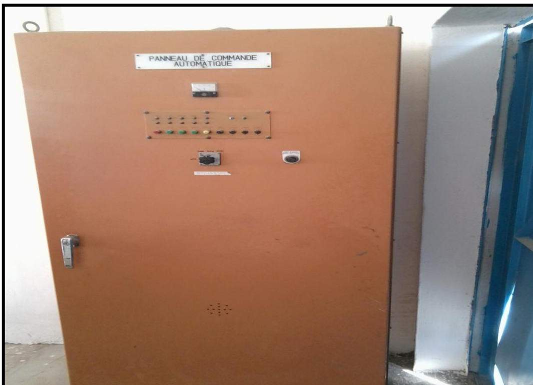
Photos N° II-20 : Une armoire électrique du groupe électrogène de la station relevage SR04. F-Chambre de transformateur (3,50 m X 3,50 m) avec des caractéristiques (50Hz Fréquence). (Ampère 10), (Volt 380 / 220v) est conçu pour répondre aux besoins dans un bon état.
