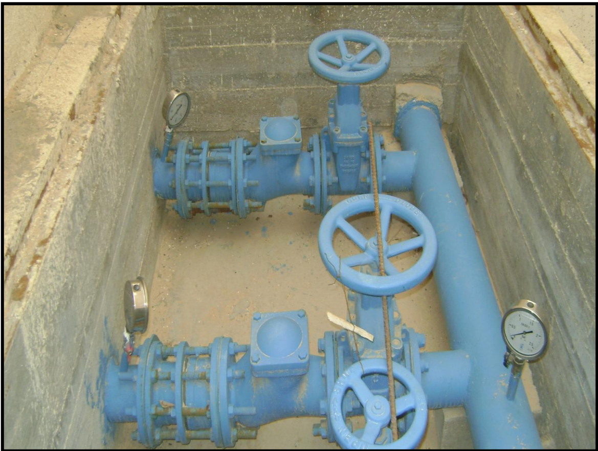
Photos N° II-33 : Chambre des vannes de la station de relevage SR 400 Logts.
