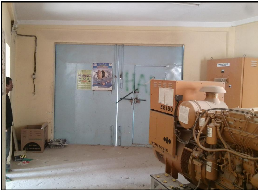
Photos N° II-28 : Chambre du groupe électrogène de la station de relevage SR06.
