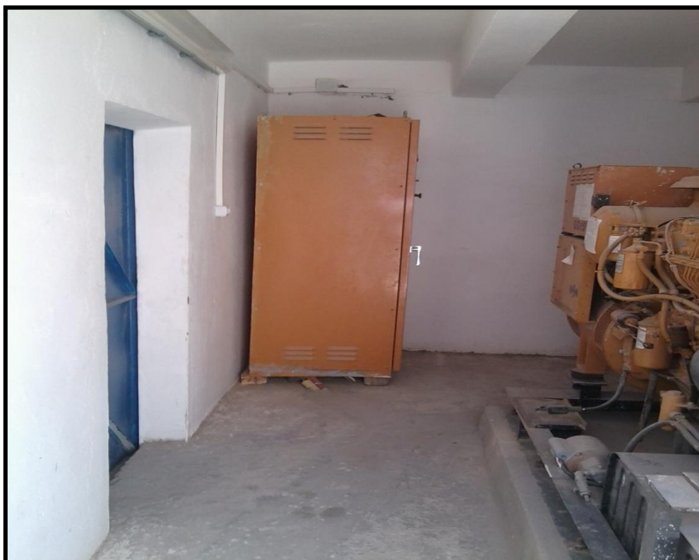
Photos N° II-09 : Une armoire électrique du groupe électrogène de la station relevage SR03.
