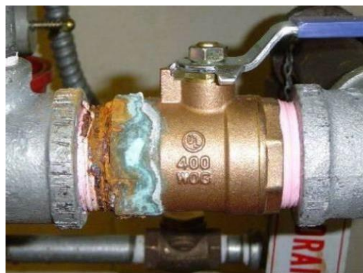
Figure I-10 : La corrosion galvanique d'un tuyau galvanisé.
