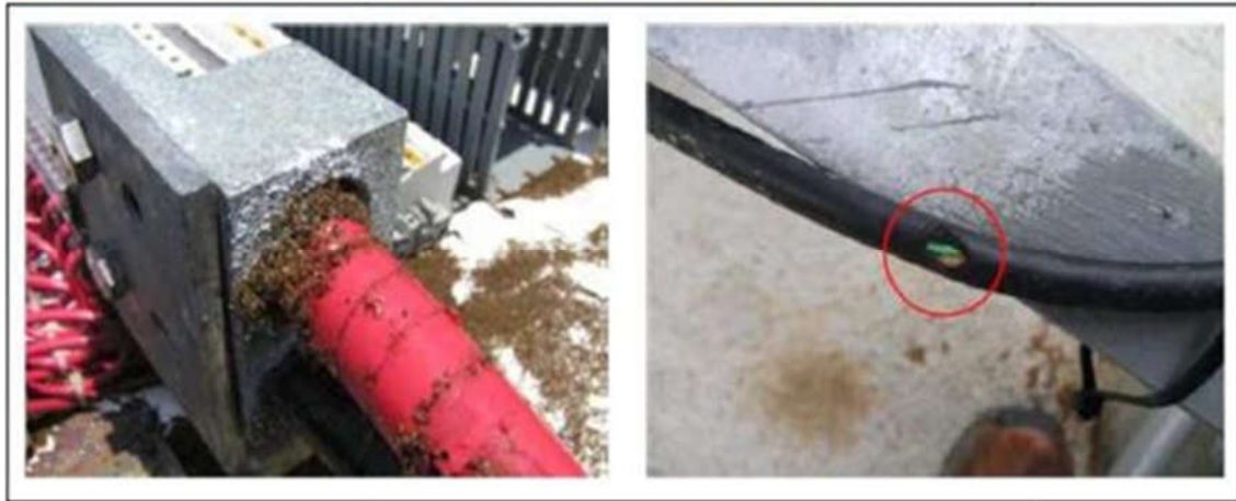
Fig. II.3:Exemples de défauts rencontrés dans le câblage
