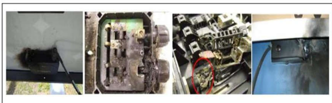
Fig. II.2 : Exemples de défauts rencontrés dans les boîtes de jonction
