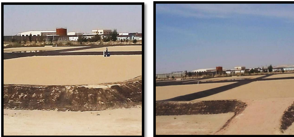
Figure 28 : Lit de séchage des boues.
