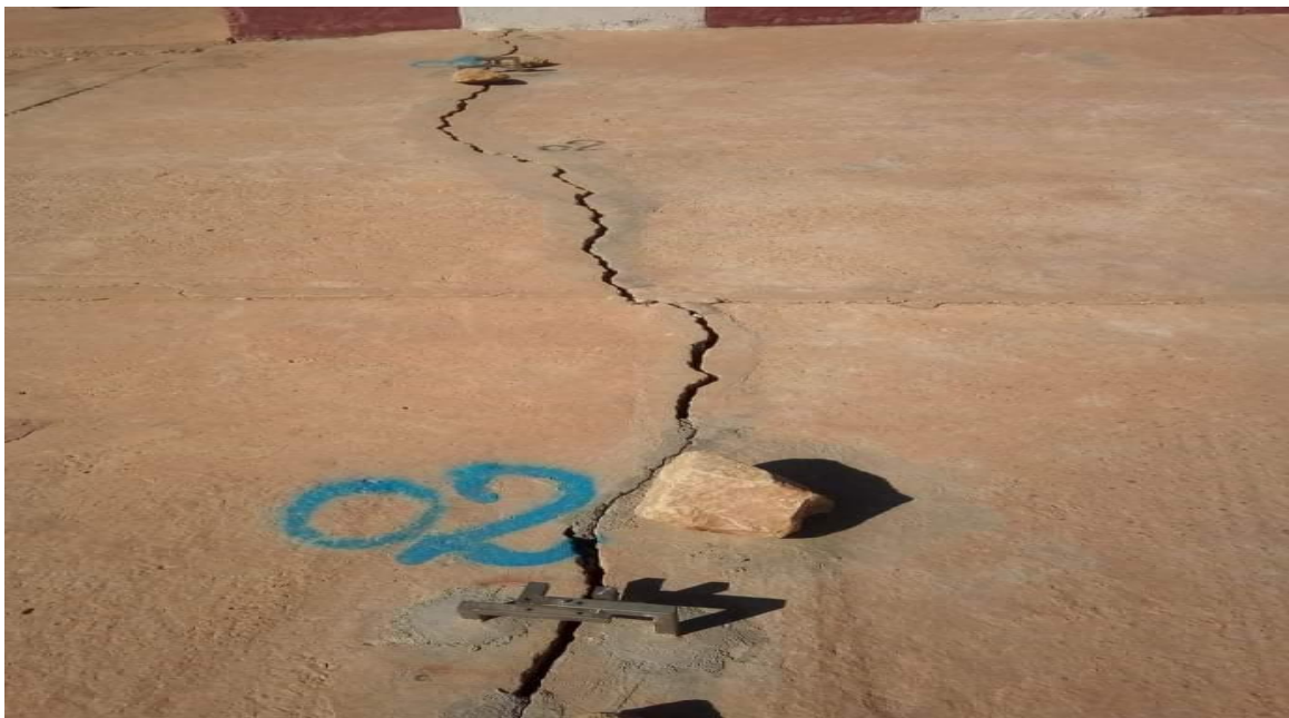
Photo 02: fissure dans le barrage
