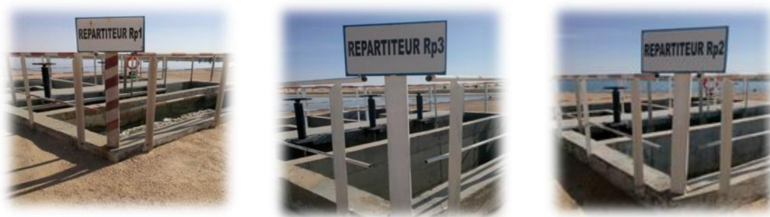
Figure 22: Répartiteur vers les bassins d'aération.
