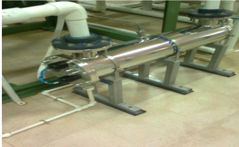
Figure 12: Appareil de stérilisation d'eau par UV.
