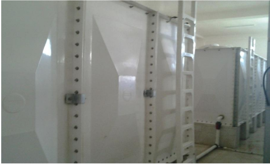
Figure 14. Réservoir de stockage d'eau après traitement
