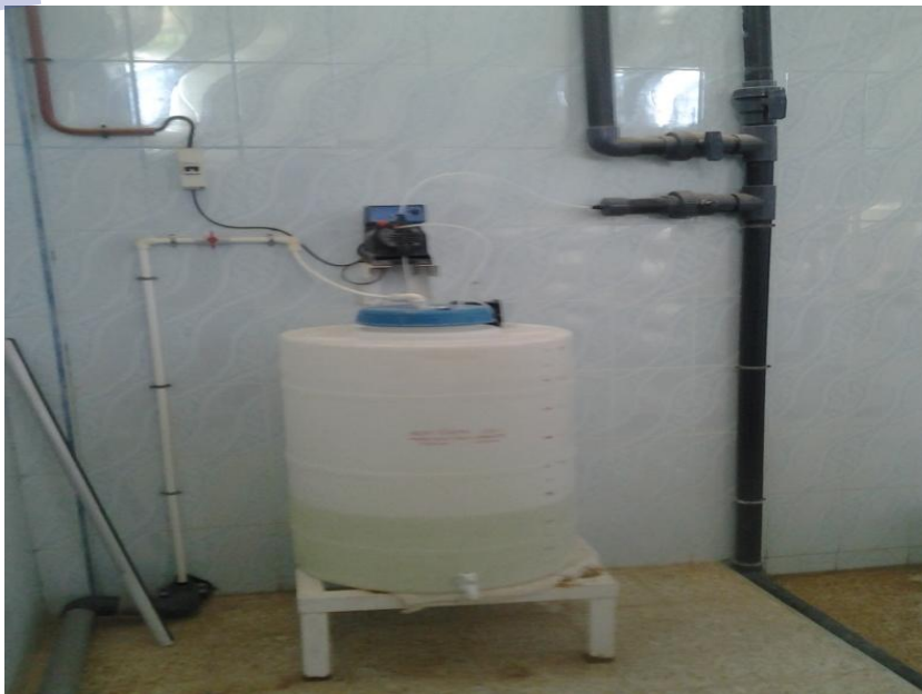
Figure 13: appareil de stérilisation d'eau par le chlore.
