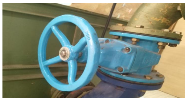
Photo 1.4: vanne de variation des débits volumiques.
