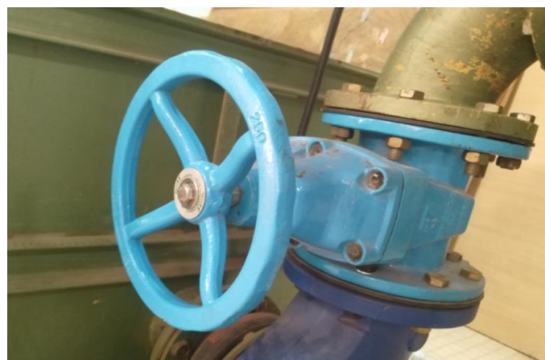
Figure 1.4: La vanne de régulation du débit.
