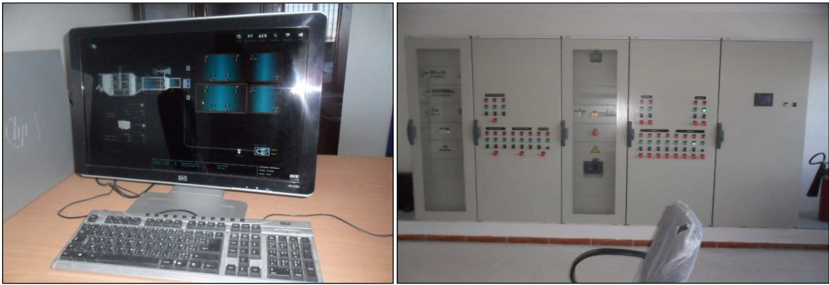
الصورة رقم(28): غرفة التحكم والمراقبة
