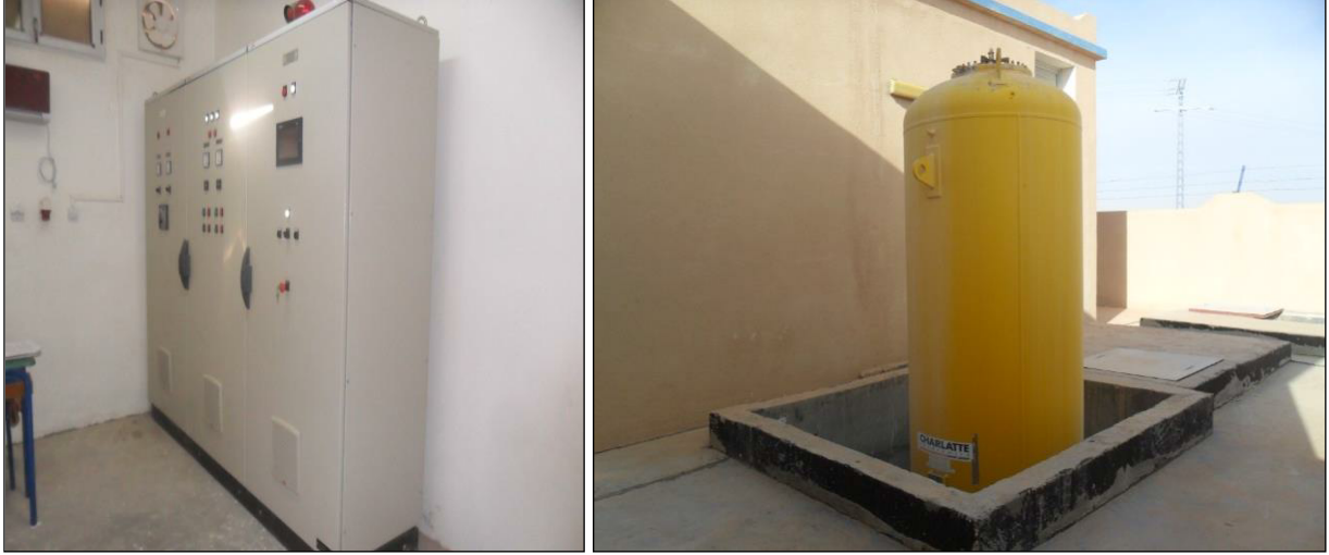
الصورة (30):محطة الضخ.
