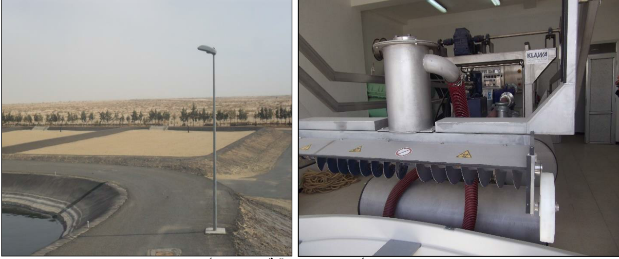
الصورة (38): أسرة تجفيف وآلة جمعالحمأة.
