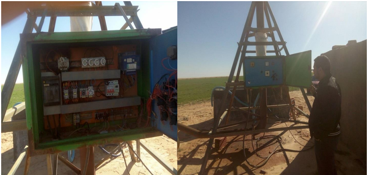
Figure I. 5: Collecteur couronnant le pivot d'une rampe
