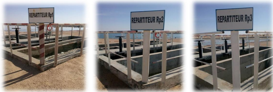
Figure(II.4) : Répartiteur vers les bassins d'aération.
