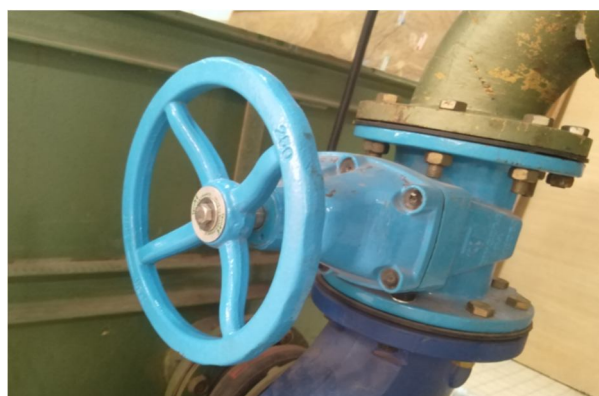
Figure 1.4: La vanne de régulation du débit.
