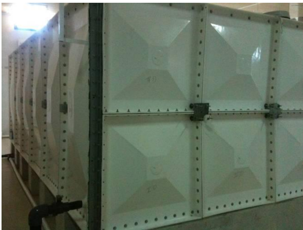
Figure IV.2 Réservoir D'eau Potable après la Traitement
