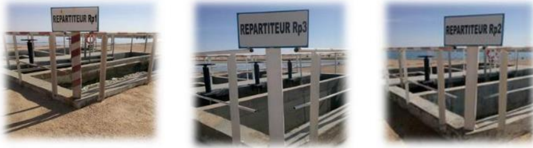
Figure 13: Répartiteur vers les bassins d'aération (ONA, 2009).
