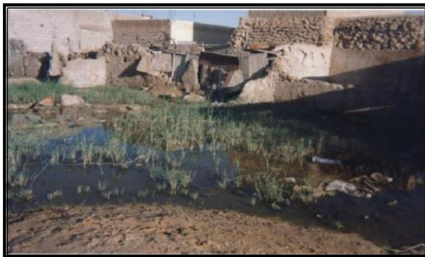
الصورة II.8 : يوضح تدهور بعض المباني الجبسية نتيجة صعود المياه [31]
