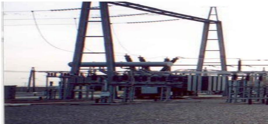
Fig III.4:Connexion de self côté arrivée de ligne.
