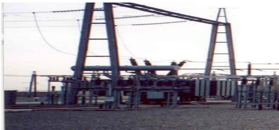
Fig III.4:Connexion de self côté arrivée de ligne.
