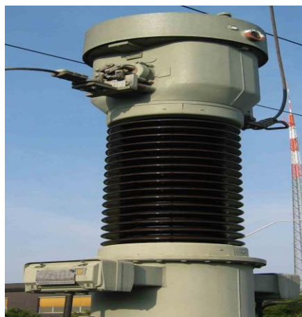
Figure III.2. Transformateur de courant
