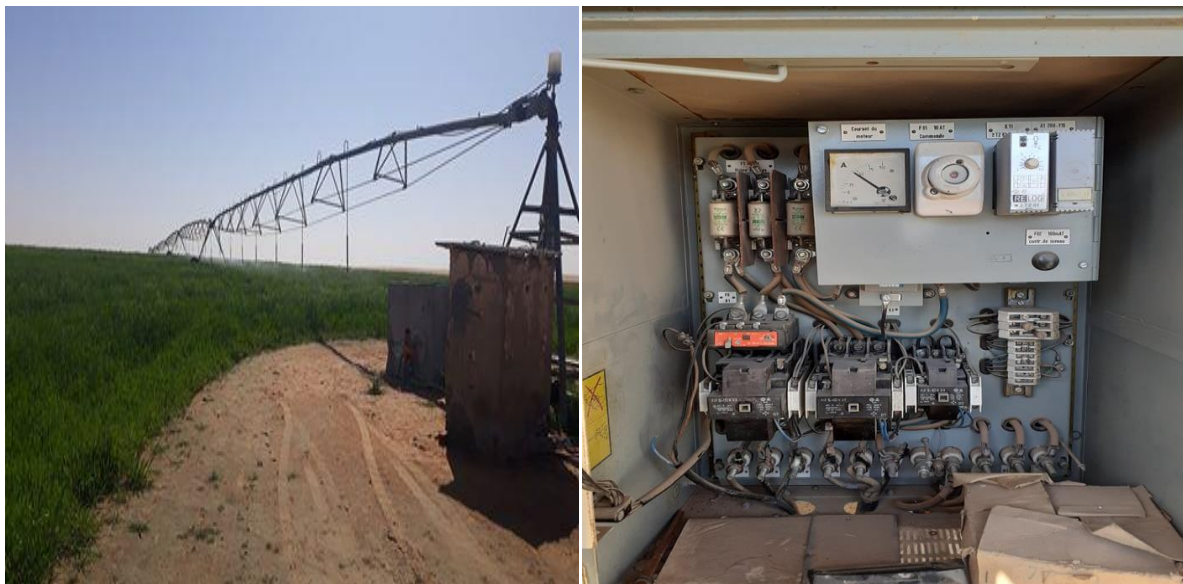
Figure I 2: Le côté électrique de pivot d'irrigation moderne.
