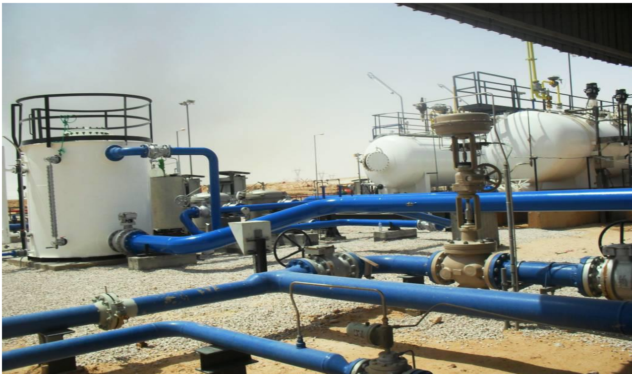
Figure 1-17 réservoir d'eau traitée
