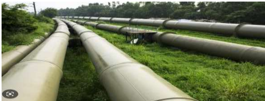
الشكل (I. 12): نقل البترول الخام بواسطة خطوط الأنابيب [55].
