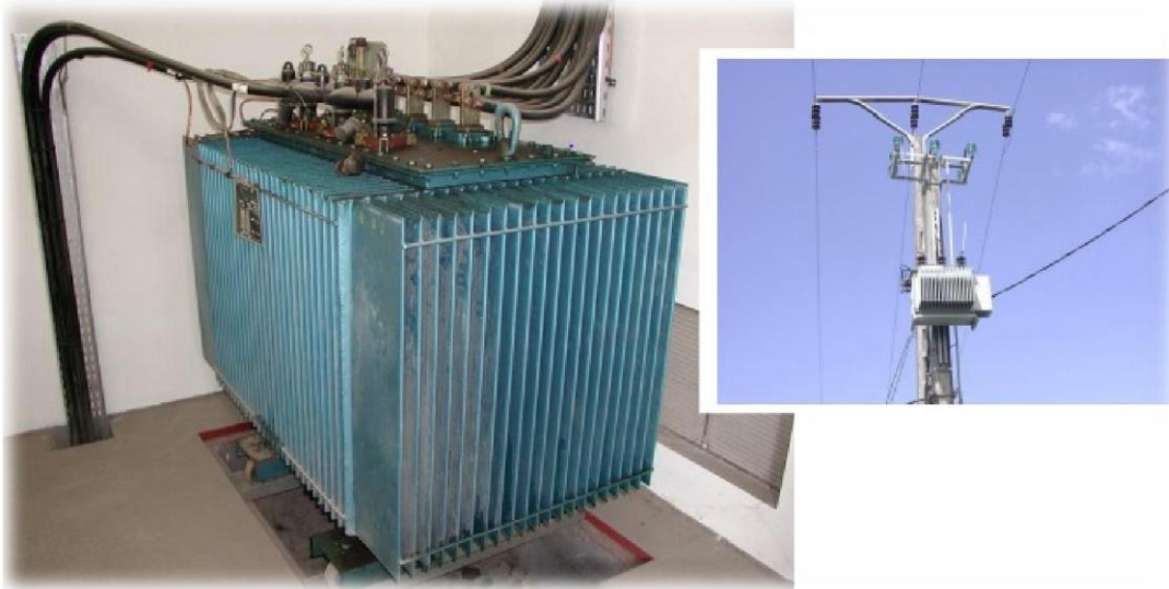
Figure III-3 Le Transformateur de puissance [95]
