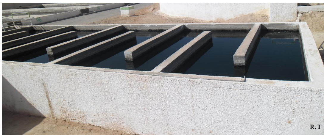
Photo 6: Bassin de chloration.
