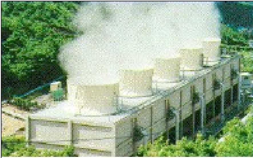
Figure 1.4 : Centrale géo thermoélectrique de Hatchobaru (Japon 300 MW)
