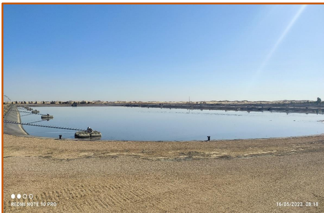
Photo N° II. 08 : Lagune aérée étage 01.
