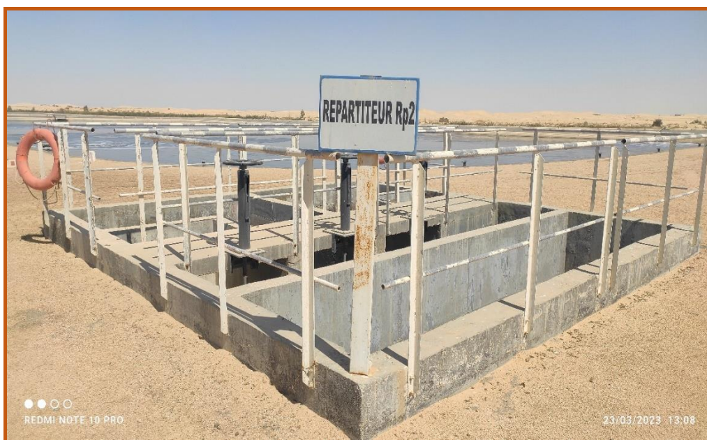
Photo N° II. 09 : Répartiteur d'eau usée (RP2).
