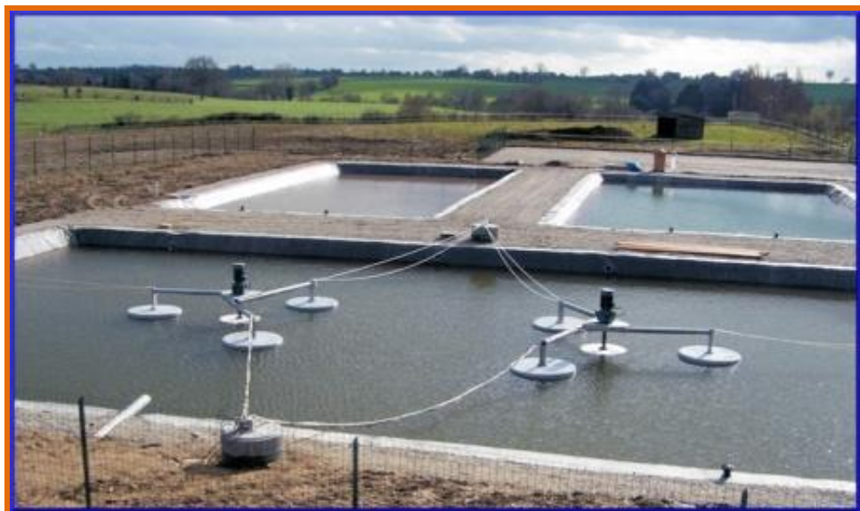
Photo I.07: Lagunage aéré avec aérateurs de surface. [40]
