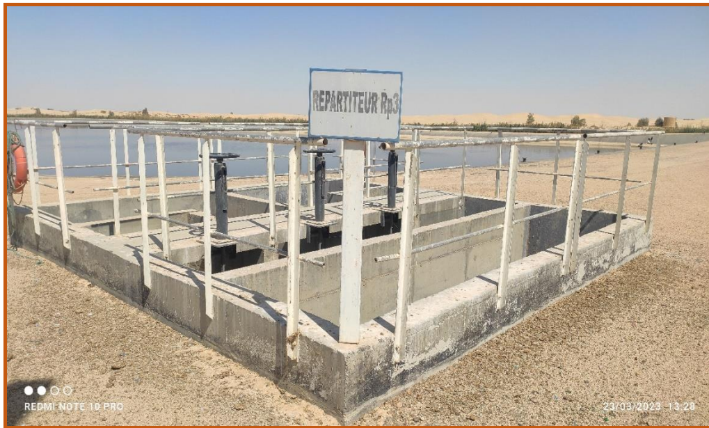
Photo N° II. 11 : Répartiteur d'eau usée (RP2).
