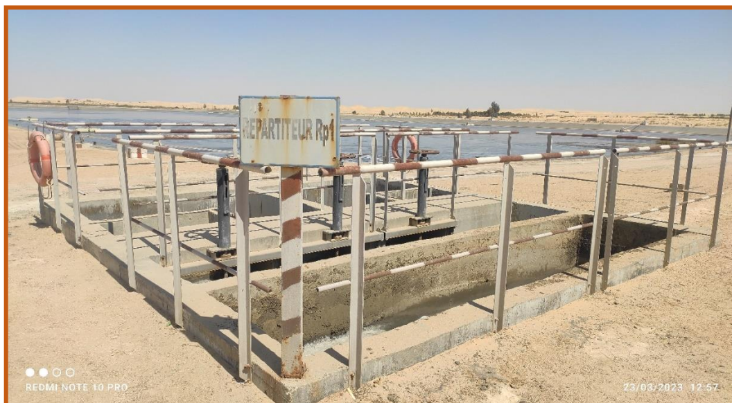
Photo N° II. 04: Répartiteur vers les bassins d'aération.
