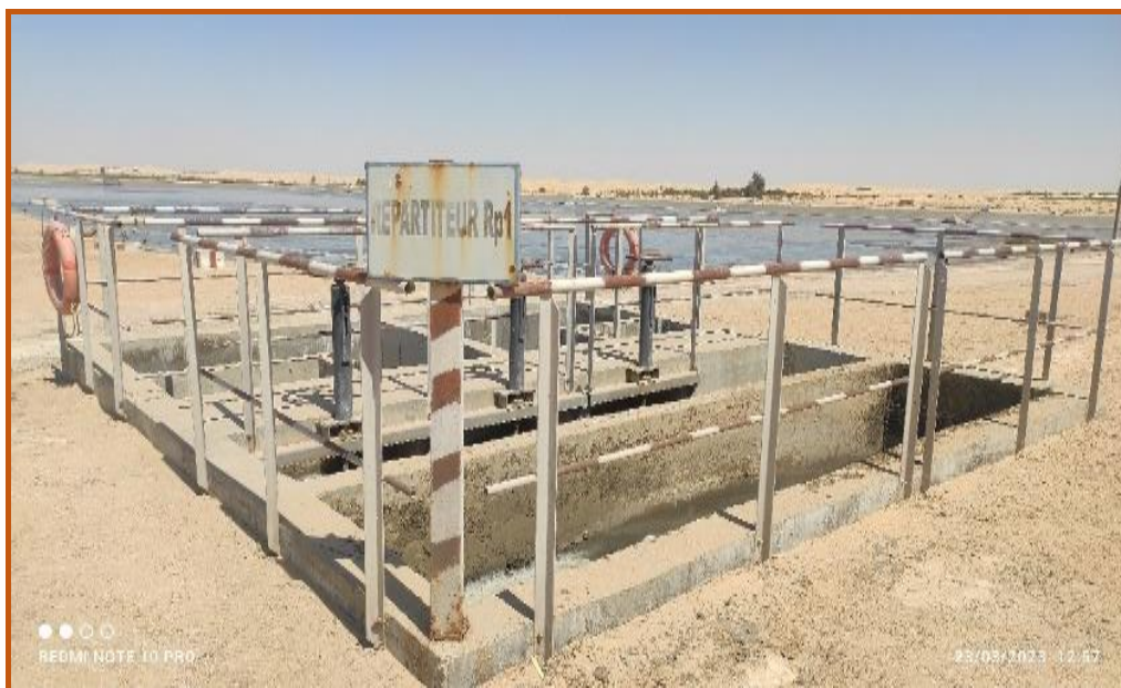
Photo N° II. 07 : Répartiteur d'eau usée (RP1).
