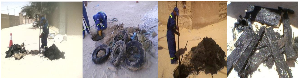
PHOTO II.7 : déchets bouchant les regards .
