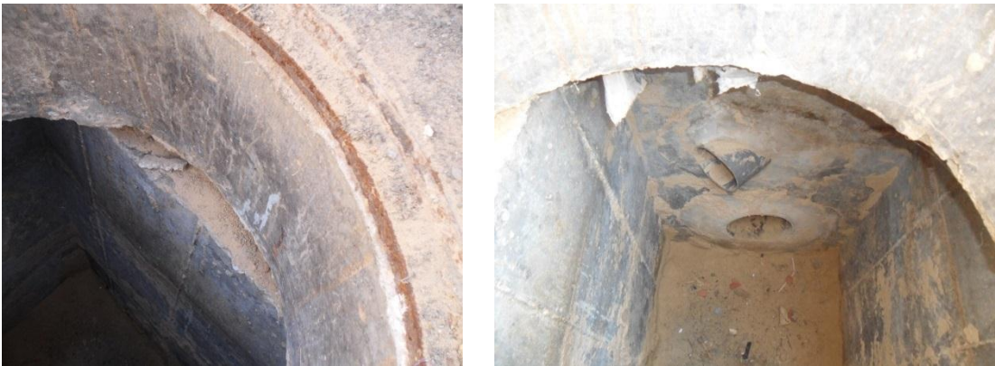
PHOTO II.3 : Regard n'est pas en service.
