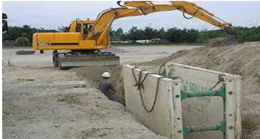
PHOTO VII.5. Sécurité contre l'effondrement
