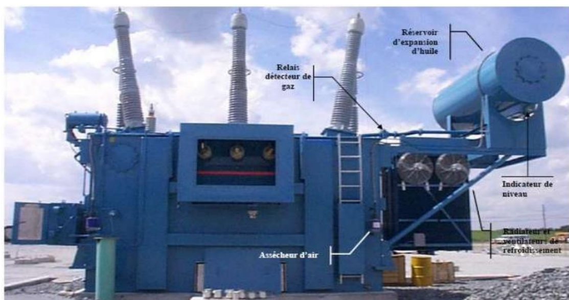
Figure III.16 Transformateur de répartition
