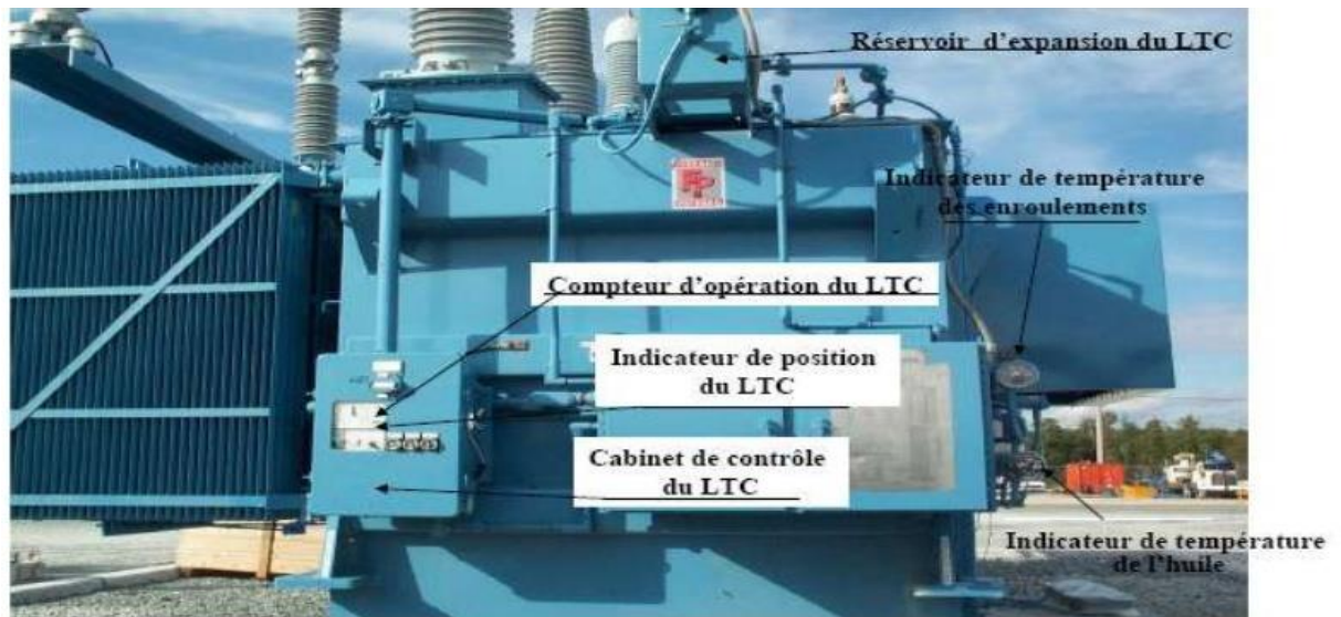
Figure III.17 Transformateur régleur en charge
