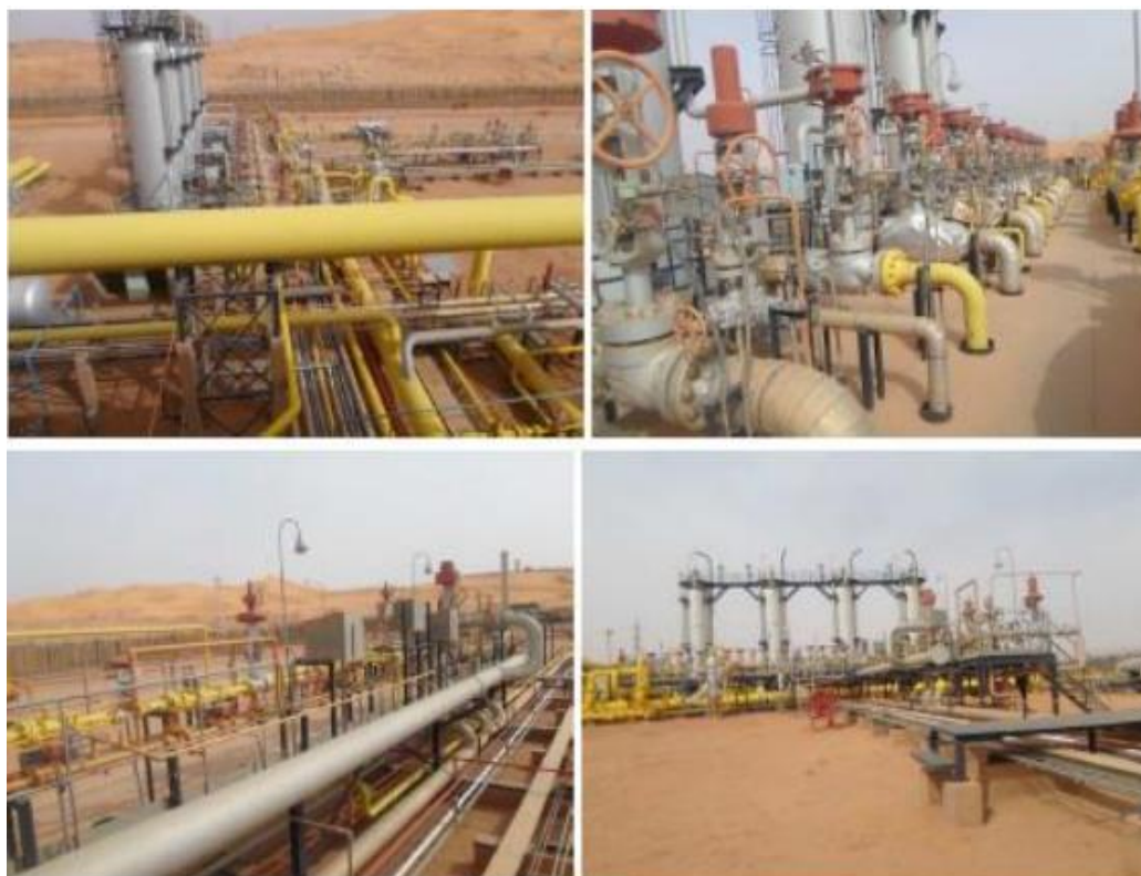
Figure (IV-08) : unité de déshydratation des gaz
