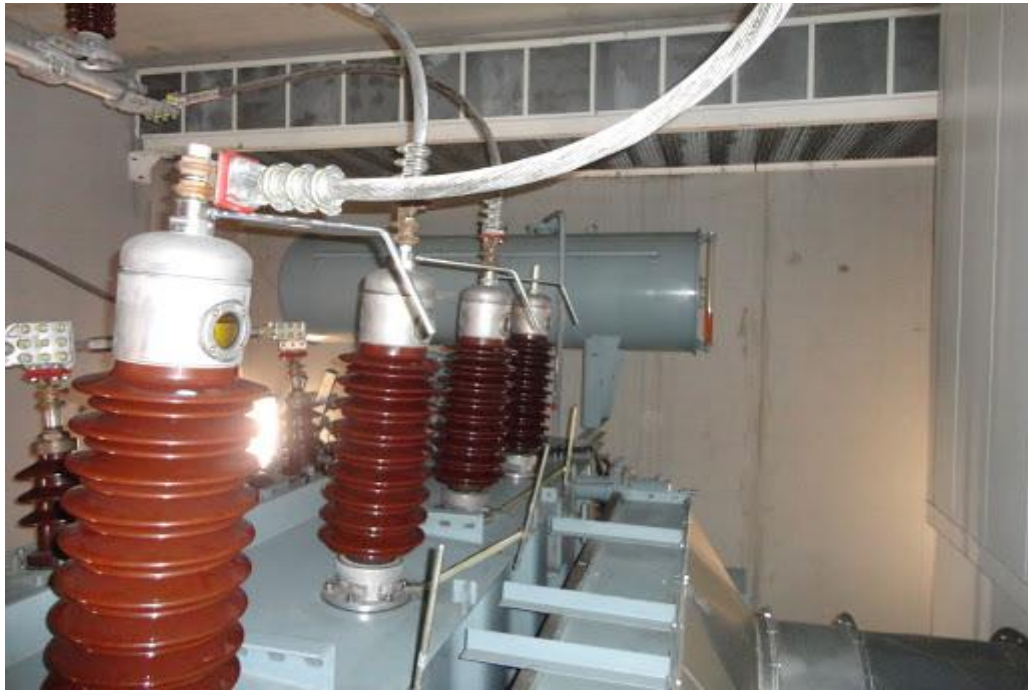
Figure (II.3) Vérification du niveau et de l'étanchéité 'huile sur les traversées[2]
