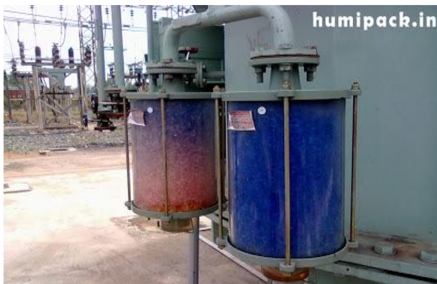
Figure (II.5) le niveau d'humidité du fluide diélectrique dans le réservoir[2]
