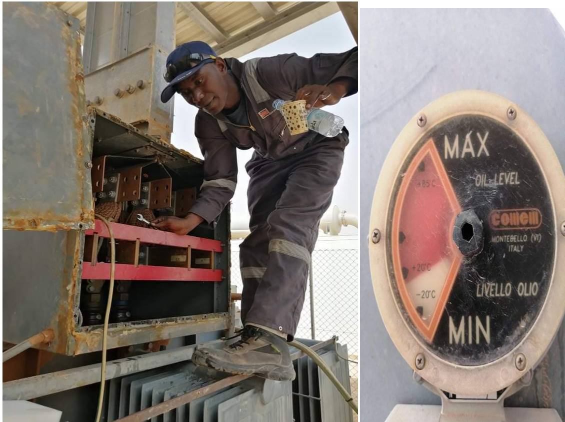
Figure (II.2) Entretien des fuites d'huile du transformateur[2]
