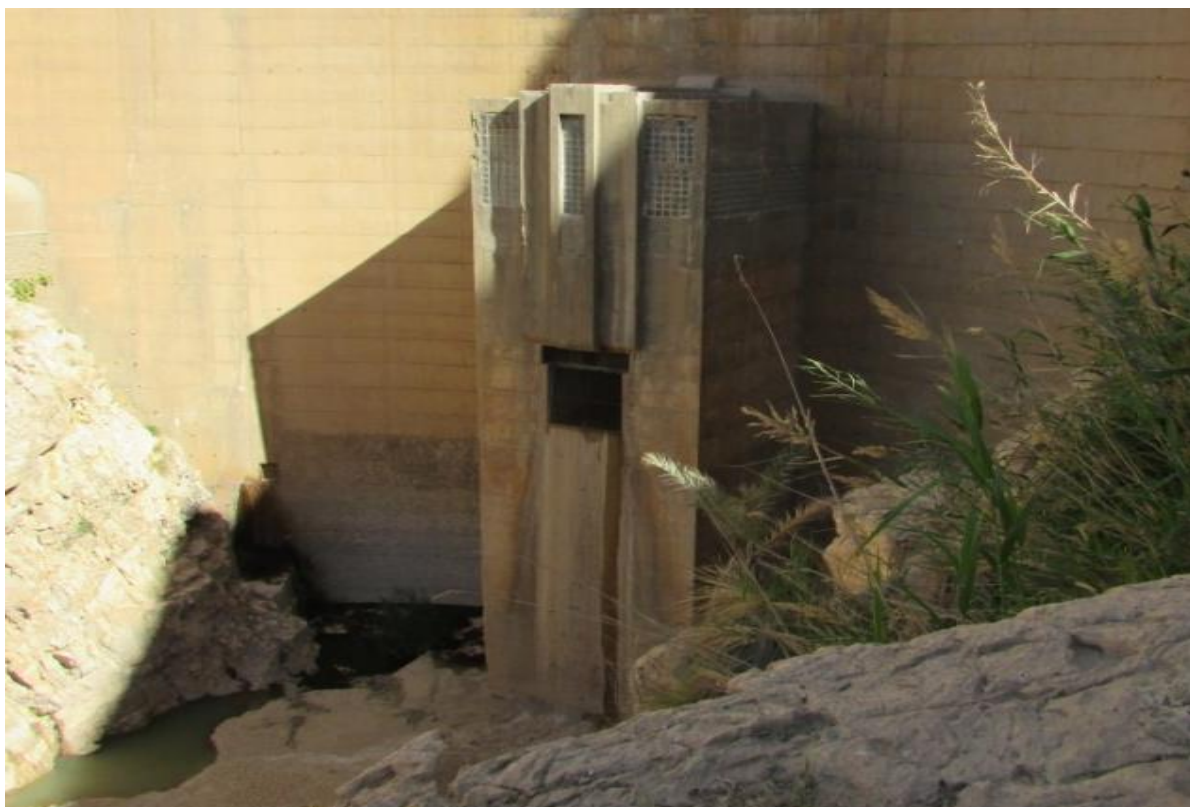
Figure 2.10 : Vanne de fond du barrage de Foum El Gherza Souvent bloquée Par les palmiers arrachés par les crues (Photo. Remini, Mai 2016)
