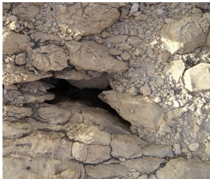
Figure 2.12: Grande ouverture au niveau de la roche de la rive droite (photo. 2017)
