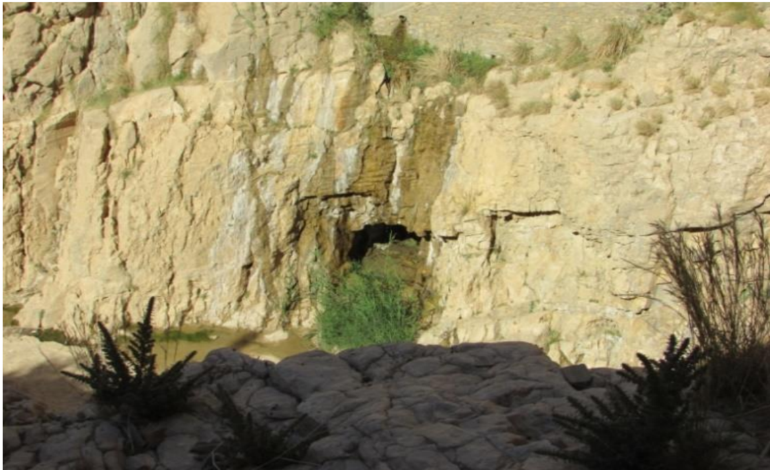
Figure 2.7 : Ruissèlement des eaux de fuites sur le massif de la rive droite du barrage de Foug El Gherza (Photo. Remini, 2005)
