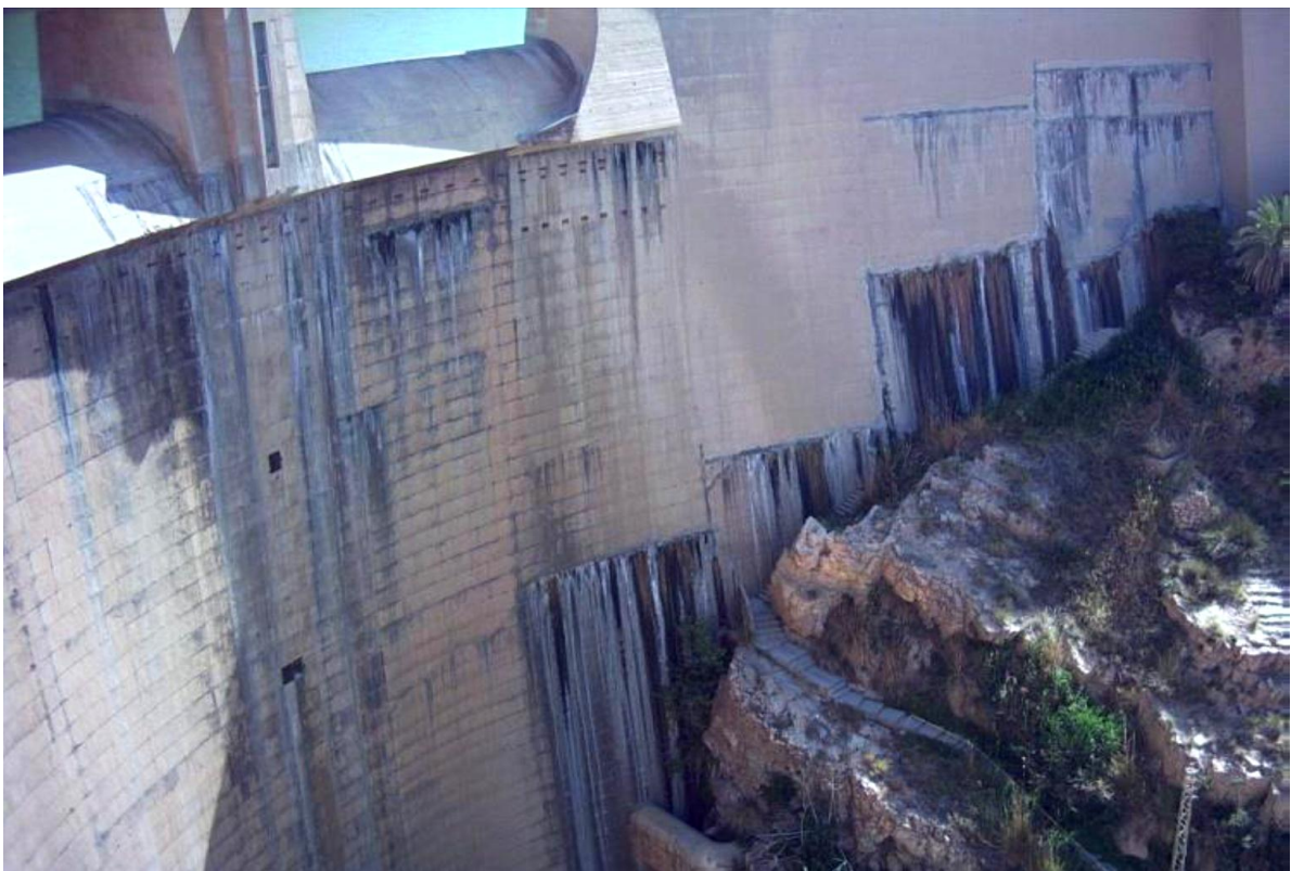
Figure 2.9: Une fuite d'eau bien visible bien que le lac est au niveau le plus bas (Mai, 2017)
