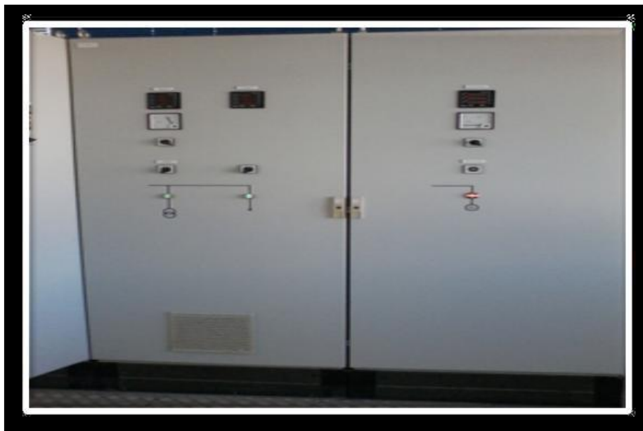
Chambre de contrôle de la station de pompage
