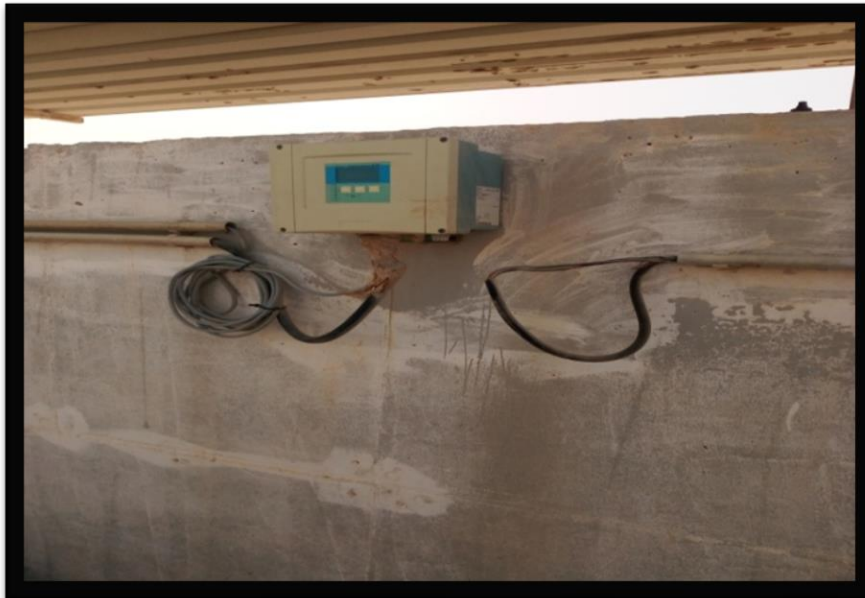
Jauge d'eau à l'intérieur et à l'extérieur(débit mètre)
