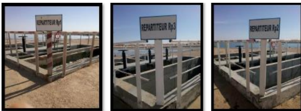
Figure.10. Répartiteur vers les bassins d'aération.
