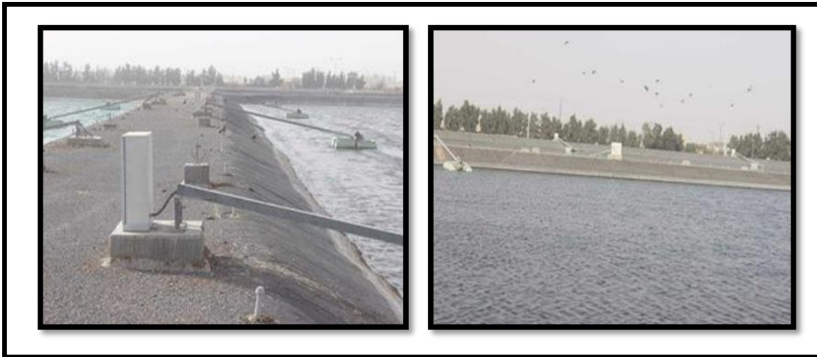
Photo07 : Station d'épuration des eaux usées de Sidi Aoun (STEP 3) (C.F.2023)
