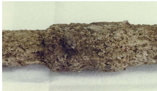
Figure I.4 : Dépôt de sulfate de calcium qui bloquait la surface d'une canalisation au point de connexion. [12]
