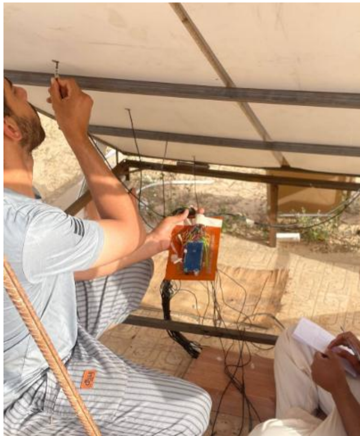
Figure (III- 34): Déplacement de capteurs de température
