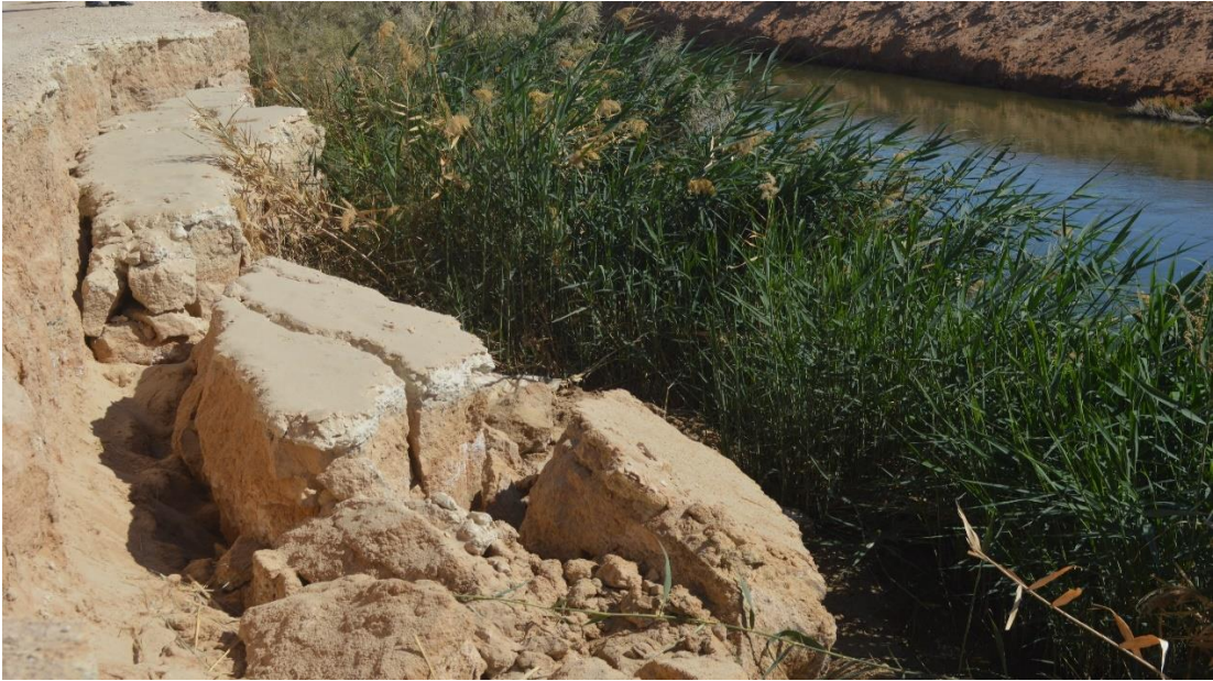
Photo IV-4 Affouillement d'une berge du canal au niveau de la zone (Tindla-Boufeggoussa)
