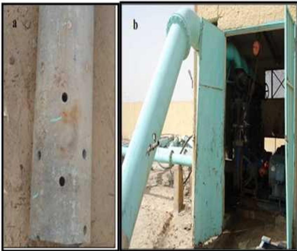
Fig.14. Conduite d'amante ciment utilisée dans le réseau de drainage (a)avec la station de pompage des eaux de drainage(b) (Réelle, 2014)
