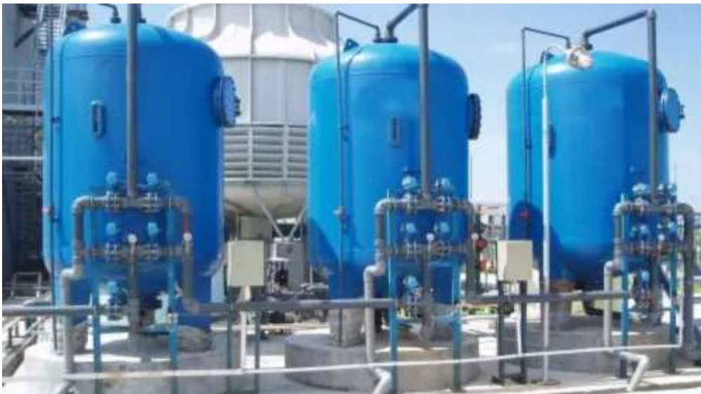
Figure (15) : Filtres à charbon actif [48].
