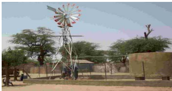
Figure. II.4 Turbine éolienne de pompage - Mauritanie ' lente'
