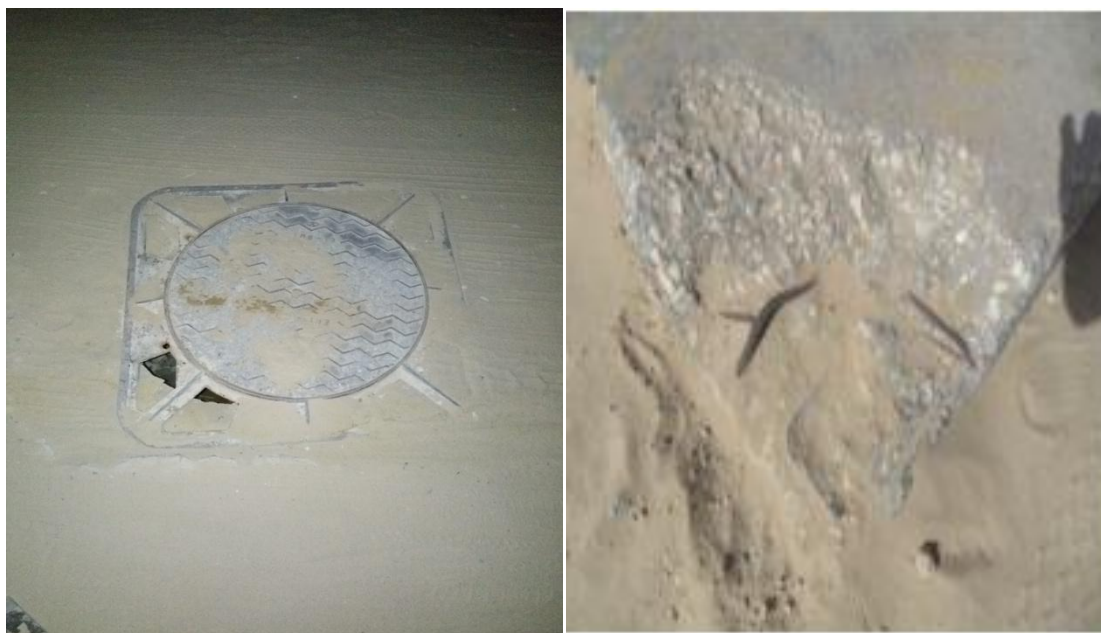
Photo. N°:( III. 04): désagrégation en béton.
