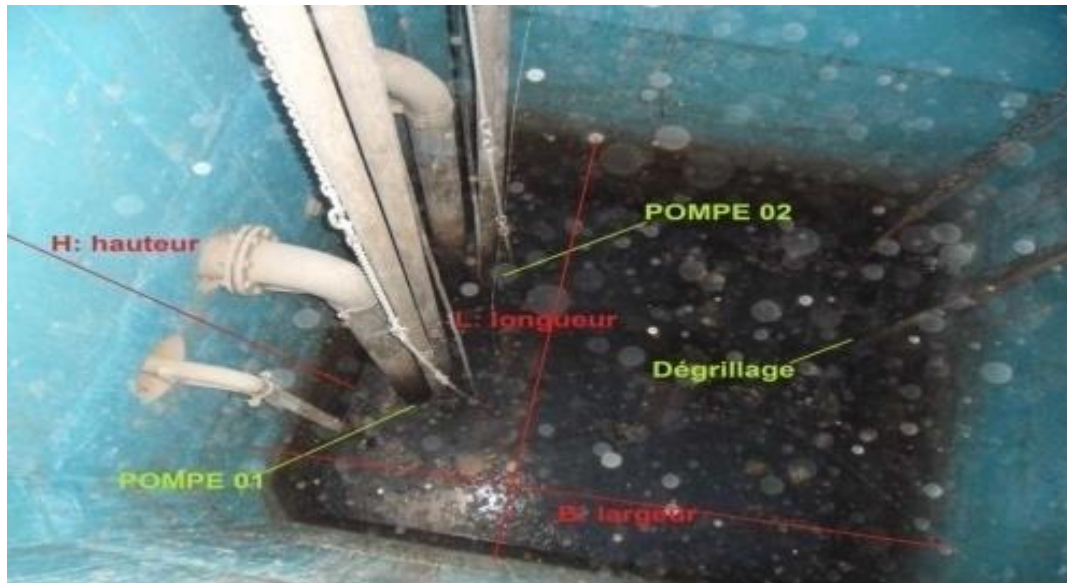
Fig. N°:( III. 09): La bache de la station de relevage (BEGGAS et H. LIHIOU,2014)
