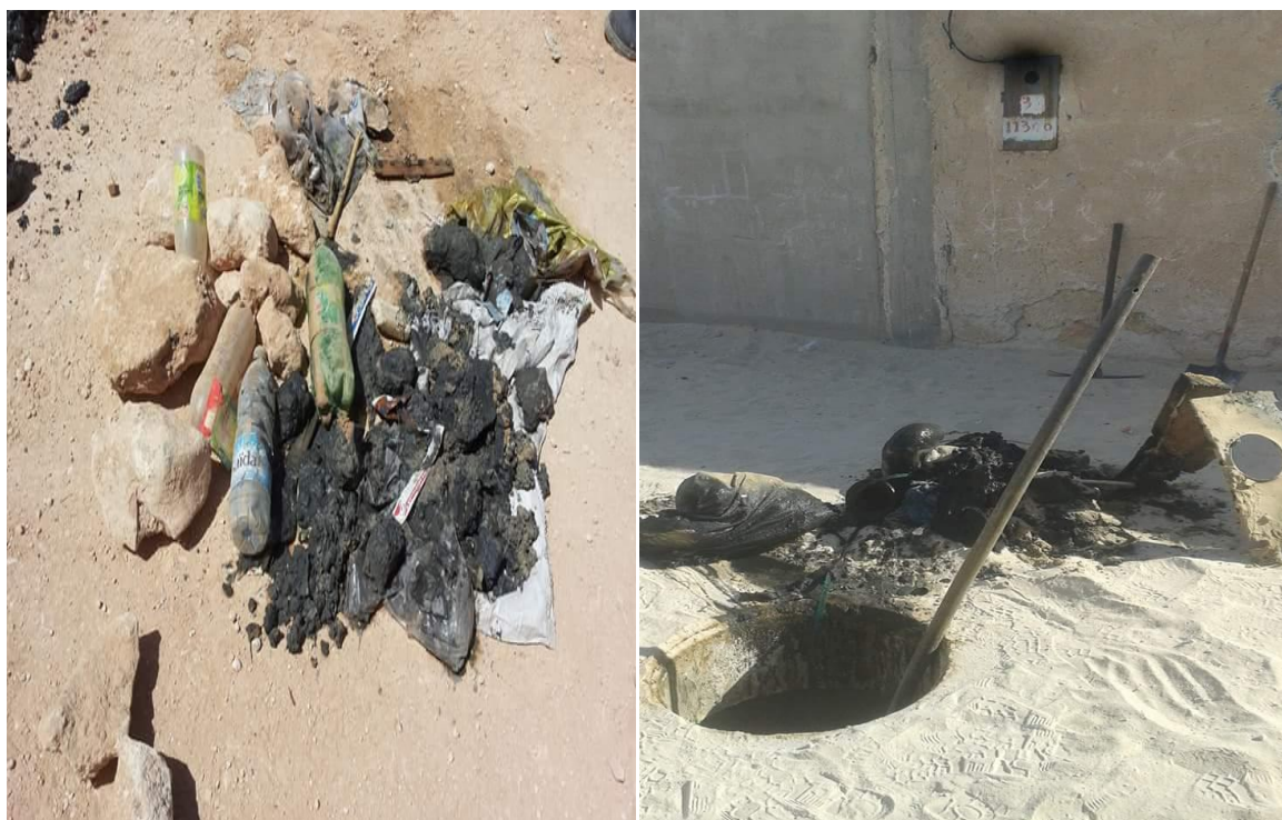
Photo. N°:( III. 07): déchets bouchant les regards.
