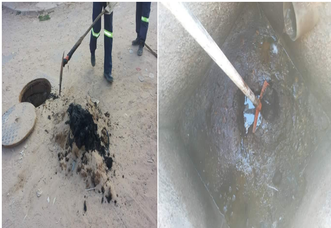
Photo. N°:( III. 06): des regards chargés du sable
