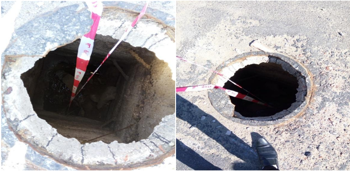
Photo. N°:( III. 08): dégradation de tampon
