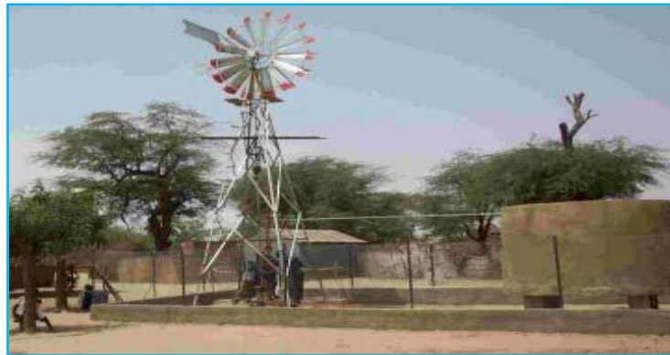
Figure 1.5.: Turbine éolienne de pompage - Mauritanie 'lente'
