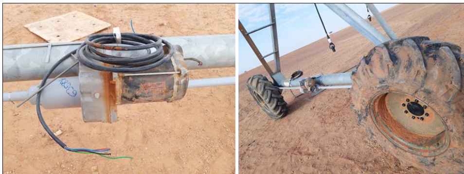
Figure I.16. Moteur électrique accouplé à un réducteur de vitesse monté sur tour mobile
