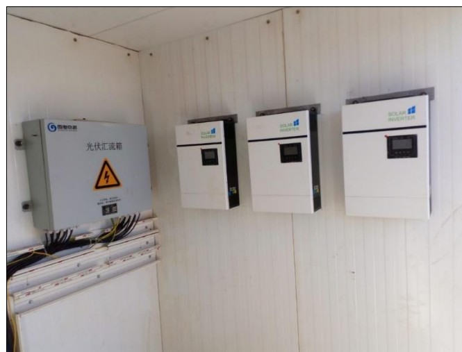
Figure IV.9 Onduleurs monophasés pour le système PV autonome
