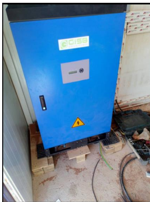
Figure IV.7 Onduleur (110kW) de pompe solaire hybride
