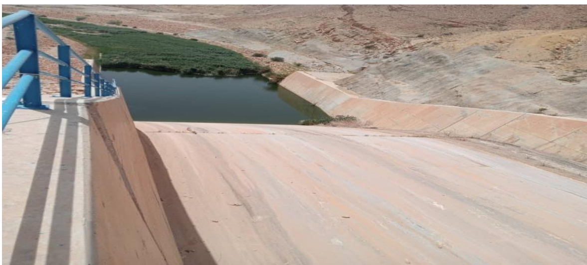
Figure II.13: Les eaux de fuites pour irrigation ( image prise depuis de téléphone)
