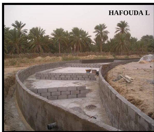
Annexe N°07: les murs alternes du bassin WWG
