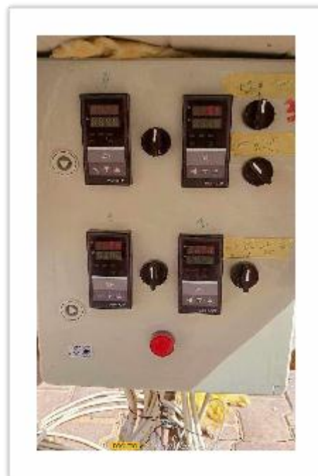
Photo III.12: Armoire de mesure.
