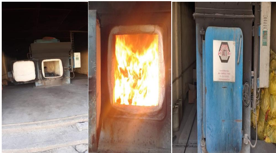
Figure 26 : L'incinérateur de l'EPH (Source : photo prise par nos soins).
