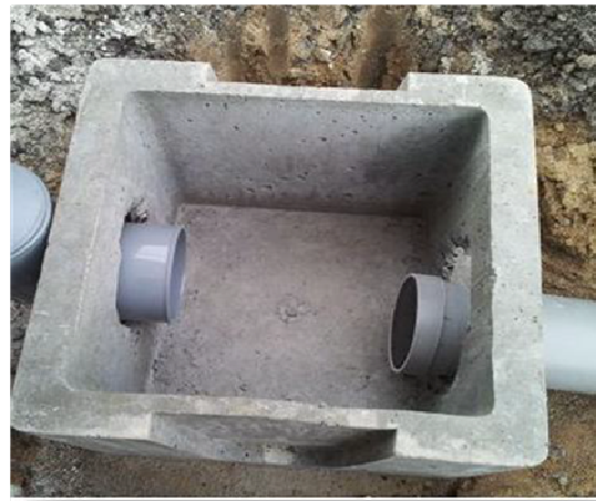
Regard de chute
