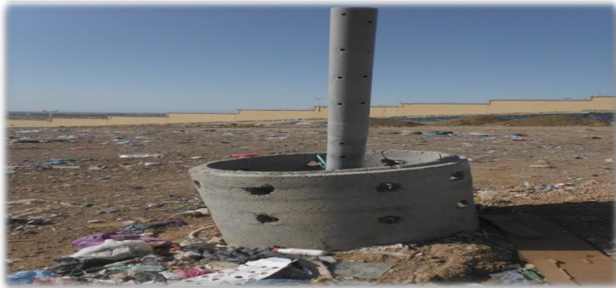
Figure N°26 : Le tube de captage du biogaz.
