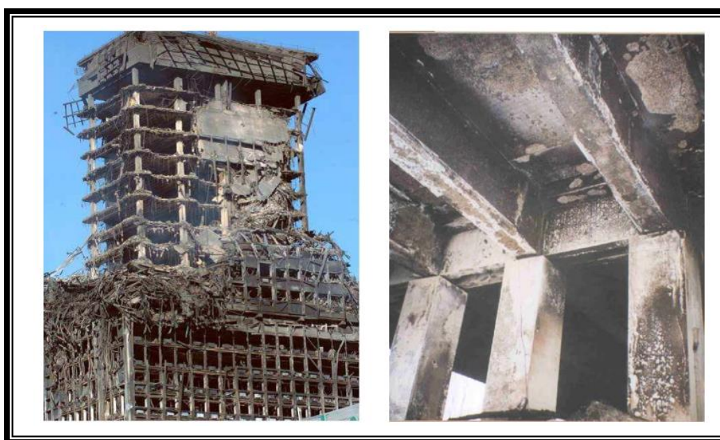
Figure I.40: À gauche, photo du bâtiment Windsor à Madrid après l'incendie. À droite, dessous du tablier du pont à Bruxelles après l'incendie [Denoël, 2007].
