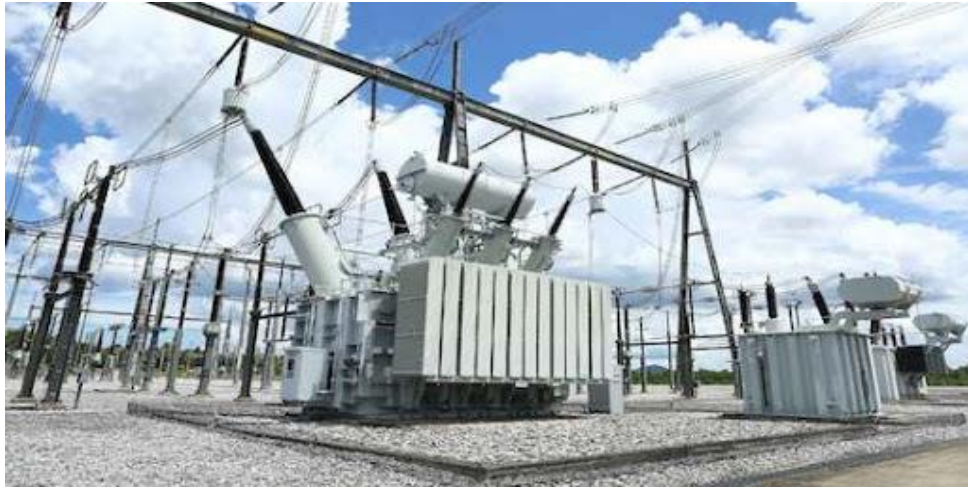
Figure I 1.transformateur de puissance
