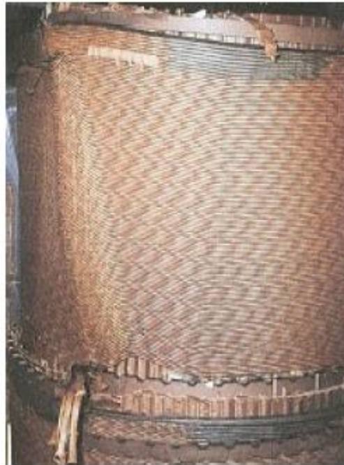
Figure. II 10. Déformation axiale de bobine
