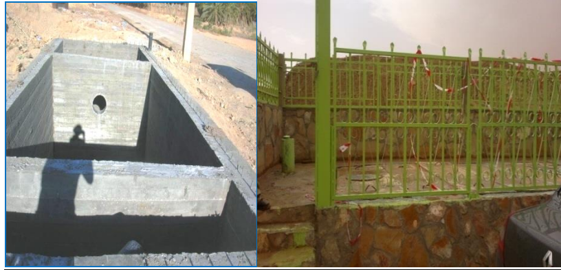
Figure 7: Vue générale de la fosse septique
